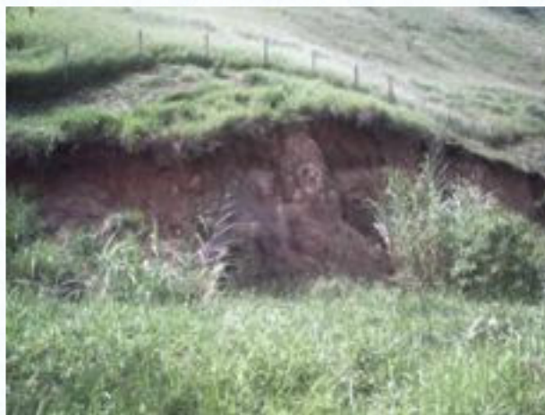
Foto 71 – Erosão à margem - direita do córrego Sta. Maria
