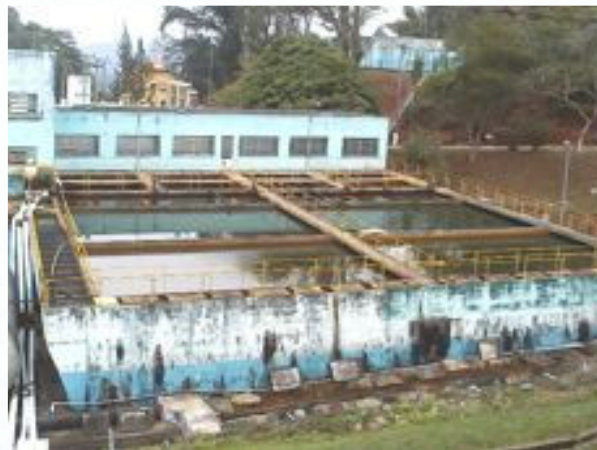
Foto 74 – Vista parcial da ETA Dr. João Penido
