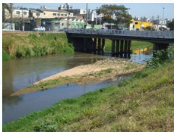
Foto 27 - Assoreamento do leito do rio Paraibuna
