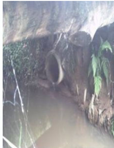
Foto 53 - Lançamento de esgoto no Ribeirão da Rosas, BE 41
