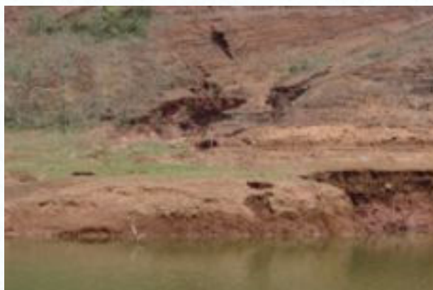
Foto 84 - Erosão por voçorocas
