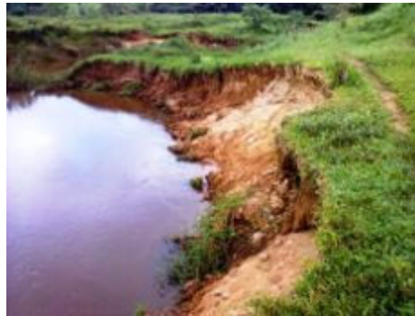
Foto 80 – Foco de erosão às margens do Ribeirão Espírito Santo- BD-24 (Fonte: Equipe UFJF/Fadepe - 2011)
