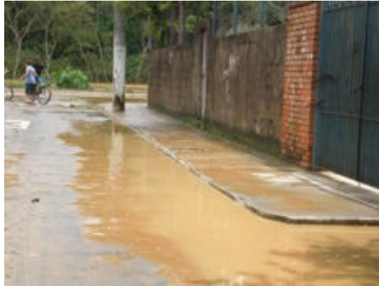
Foto 23 - Via pública alagada no Bairro Industrial, Córrego Humaitá, BD 39
