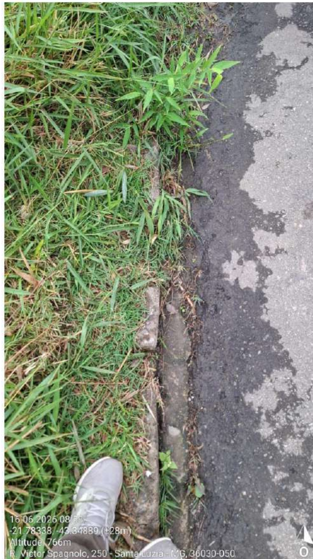
Figura 06 - Local da Intervenção: -21.78338 -43.34889 - Abertura observada entre o meio-fio e a faixa pavimentada da Rua Victor Spagnolo, evidenciando deformação localizada da borda da plataforma viária no trecho adjacente à área de intervenção proposta.
