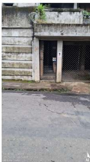
Figura 05 - Local da Intervenção: -21.78339, -43.34888 -Trecho da via adjacente à edificação lindeira, onde se observa a presença de trinca no pavimento, demonstrando a proximidade entre a área de instabilização e as construções existentes.
