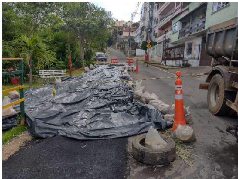
Figura 02 - Local da Intervenção: -21.783441, -43.348980 - Medidas emergenciais de proteção implantadas no trecho afetado da Rua Victor Spagnolo, consistindo na cobertura do talude com lona plástica, isolamento da área e utilização de sacarias para mitigação provisória dos processos de instabilização do terreno.
