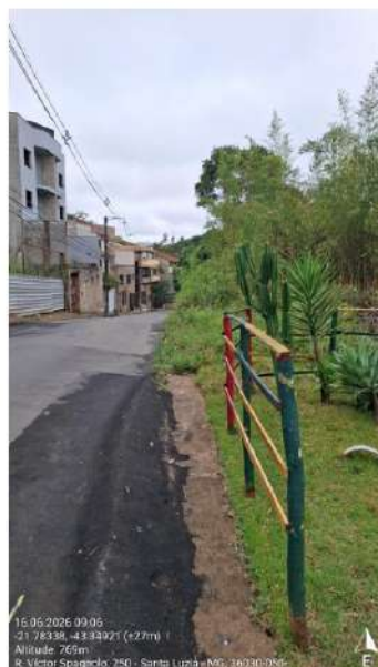
Figura 04 - Local da Intervenção: -21,78338, -43,34921 - Condição atual do trecho afetado após a execução das medidas emergenciais, observando-se a faixa de rolamento adjacente ao talude e a necessidade de solução definitiva para estabilização do terreno.
