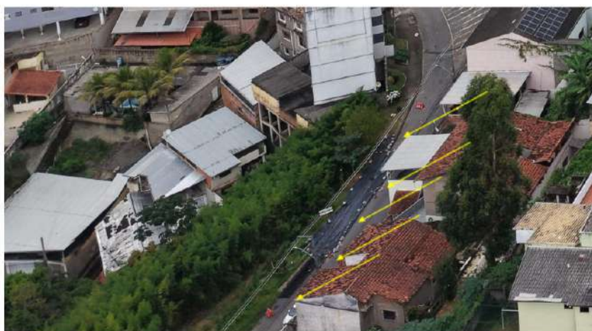
Figura 03 - Imagem obtida com auxílio de uso de drone, apresentando a extensão da área com formação da superfície de cisalhamento
